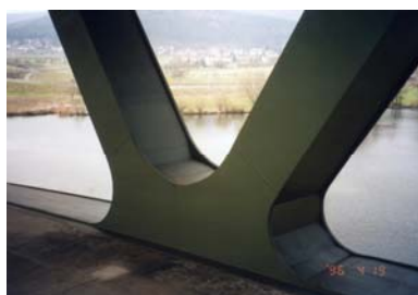
繊細な配慮 水処理
